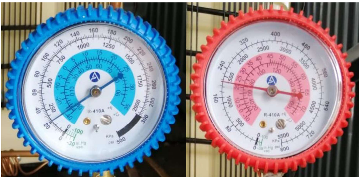
Figura 3.38. Presiones de alta y baja con el sistema encendido. Fuente propia.
