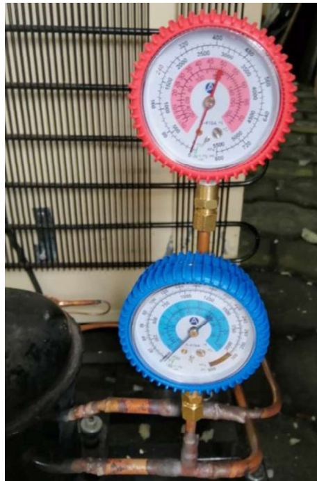
Figura 3.21. Manómetros de alta y baja. Fuente propia.
