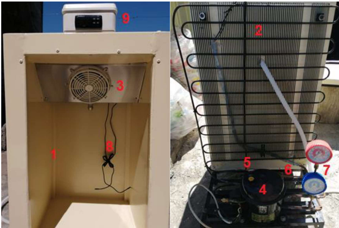
Figura 3.31. Sistema de refrigeración. Fuente propia.
