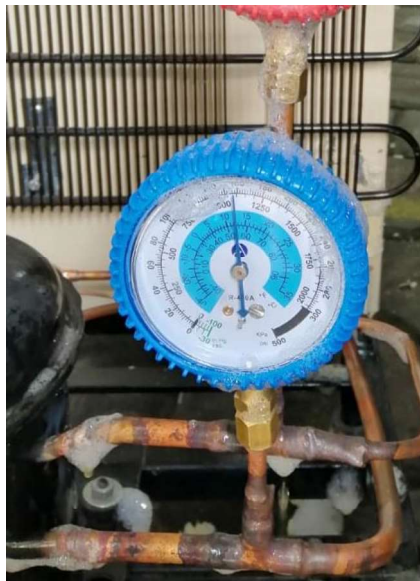
Figura 3.32. Detección de fugas en las uniones con espuma. Fuente propia.
