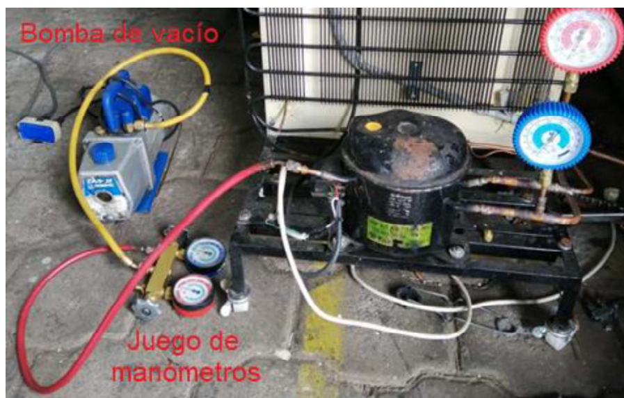
Figura 3.35. Prueba de vacío. Fuente propia.
