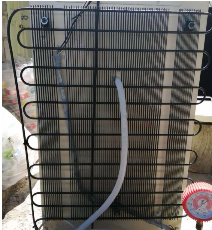
Figura 3.15. Condensador dentro del sistema. Fuente propia.
