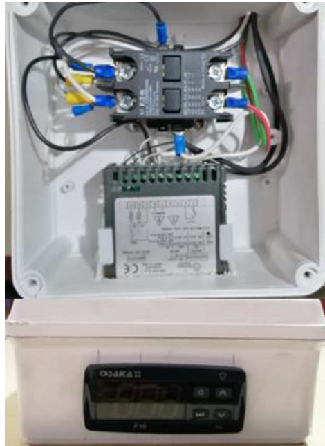
Figura 3.20. Controlador y contactor. Fuente propia.
