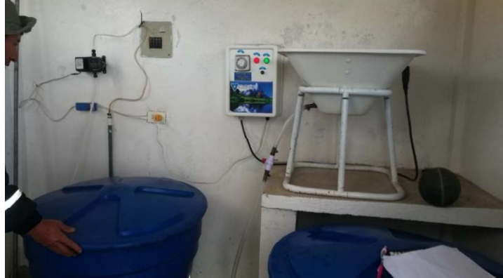
Figura 11 Sistema de cloración Fuente: El autor, 2019
