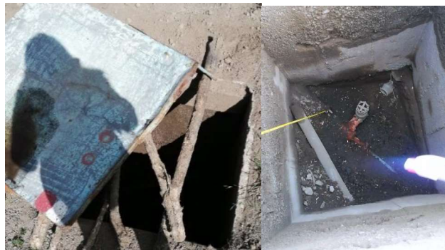
Figura 16 Pozo de revisión San Francisco de Cruz Loma Fuente: El autor, 2019
