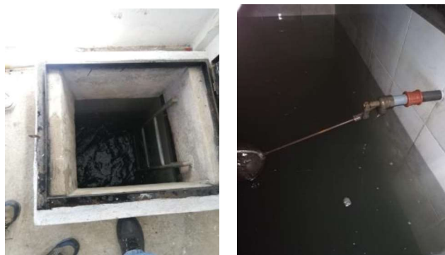
Figura 19 Tanque de almacenamiento Fuente: El autor, 2019
