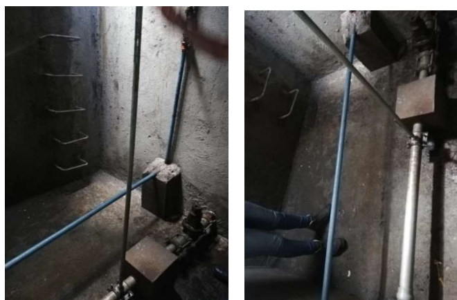
Figura 18 Cámara de tuberías Fuente: El autor, 2019
