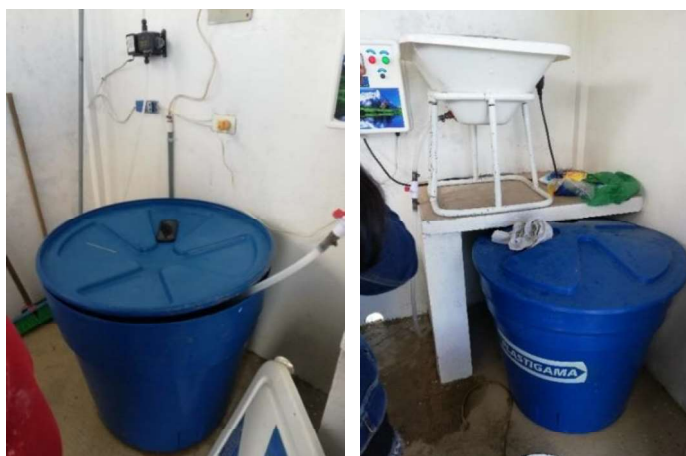
Figura 25 Sistema de cloración-Clorid Fuente: El autor, 2019
