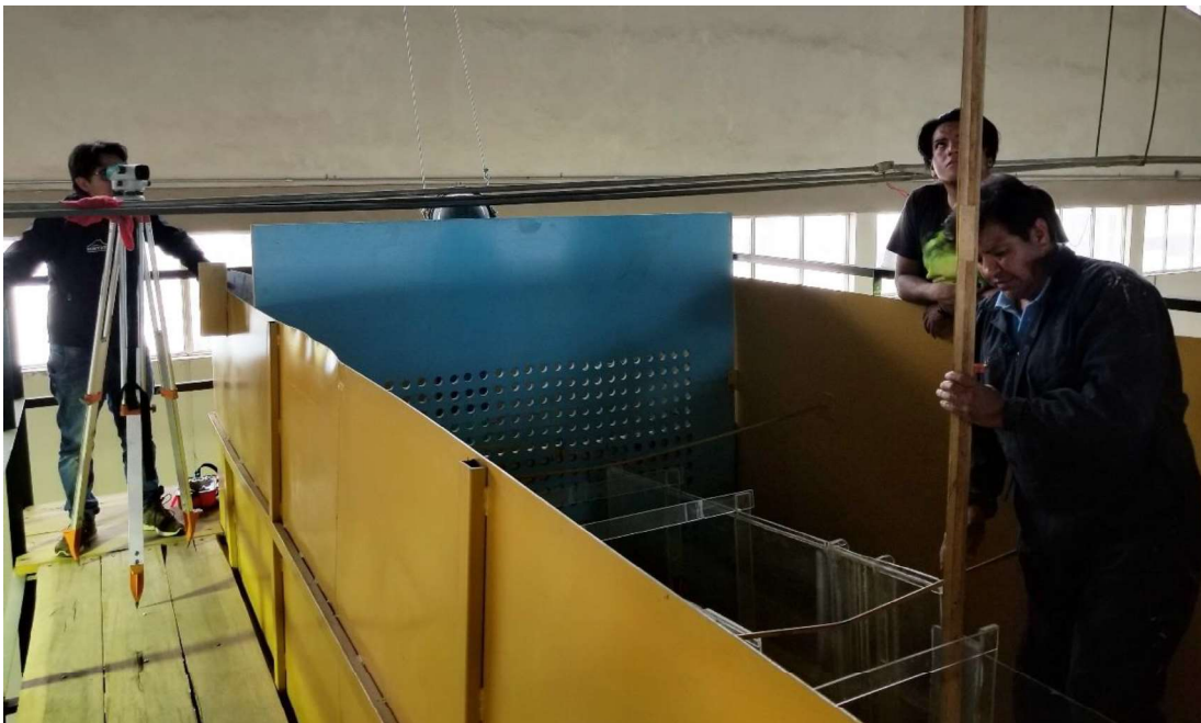
Fotografía No. 4: Comprobación de niveles y pendiente del canal de ingreso dentro del tanque de abastecimiento.
