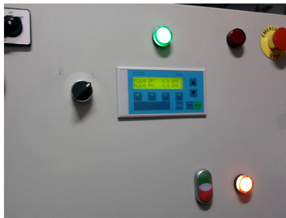
Figura. 5.1 Panel trabajando en modo local.
