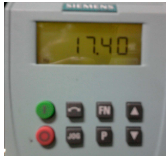
Figura 5.17 Pruebas sobre el variador de velocidad desde el BOP (bomba funcionando a 17.4 Hz)
