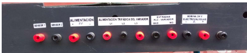
Figura 3.46: Borneras de conexión de la parte lateral izquierda del sistema.
