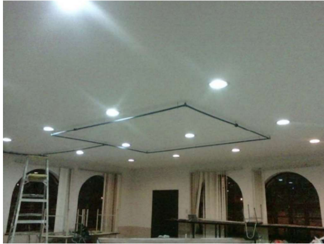
Figura 3.10 Instalación del sistema con inclinación a 10°.
