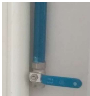
Figura 3.12: Válvula de purga.
