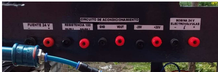
Figura 3.45: Borneras de conexión de la parte lateral derecha del sistema.
