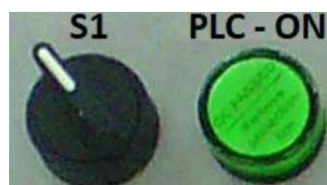
Figura 3.30: Encendido del módulo.
