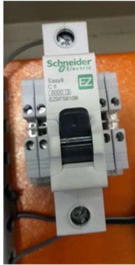
Breaker principal de alimentación del tablero
