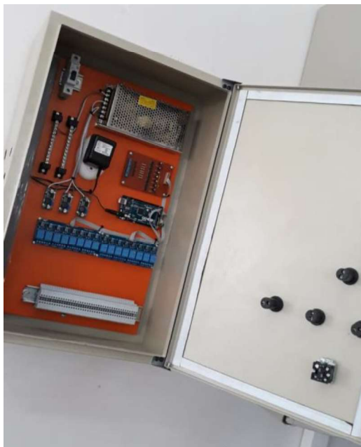
Figura 3.12. Tablero en su etapa final, perforado e instalado. (Fuente: Propia)
