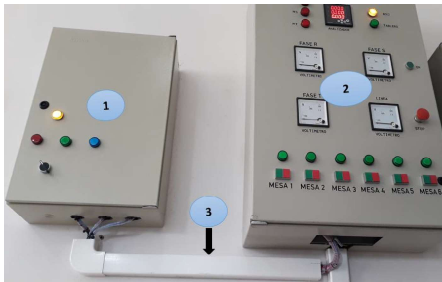
Figura 3.6. Tablero de servicio principal, tablero remoto y canaleta PVC. (Fuente: Propia)
