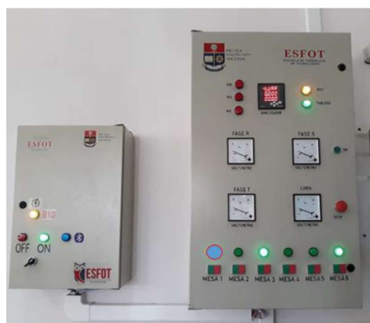
Figura 3.32. Accionamiento del tablero general y las mesas 3 y 6.
