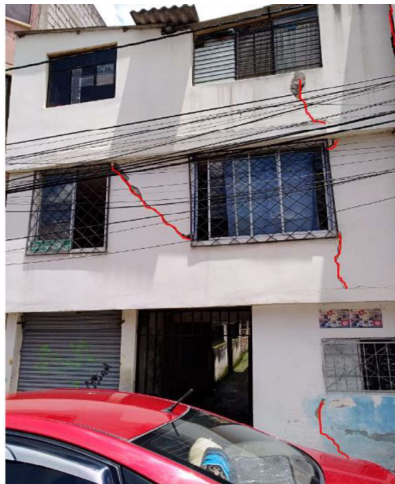
Figura 19 –Grietas en Casa puente ampliada. Se puede observar una separación hacia el lado izquierdo respecto la vivienda adyacente.
