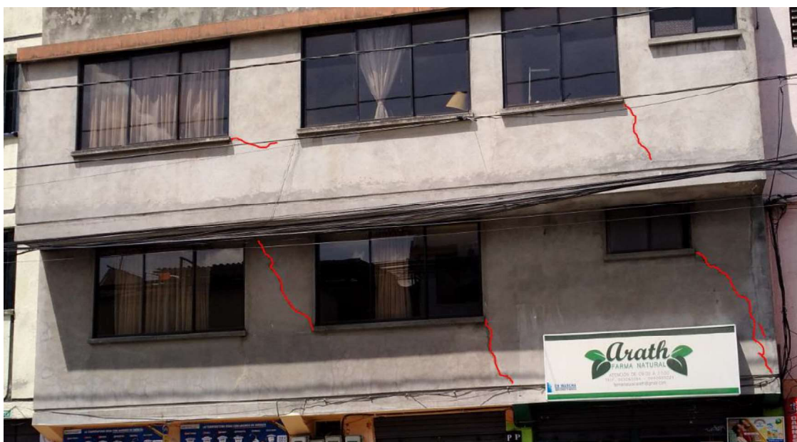
Figura 17- Grietas en vivienda regular de 3 pisos
