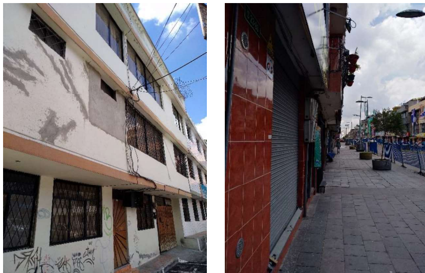
Figura 15-Volados en viviendas de Solanda-Sector1.
