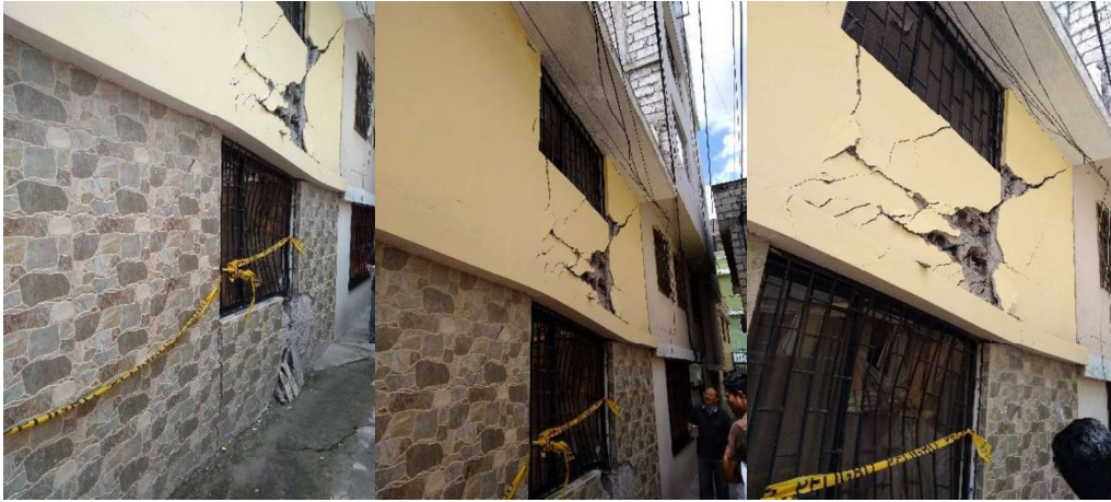
Figura 22- Grietas formando escuadra a 45° sobre la ventana.
