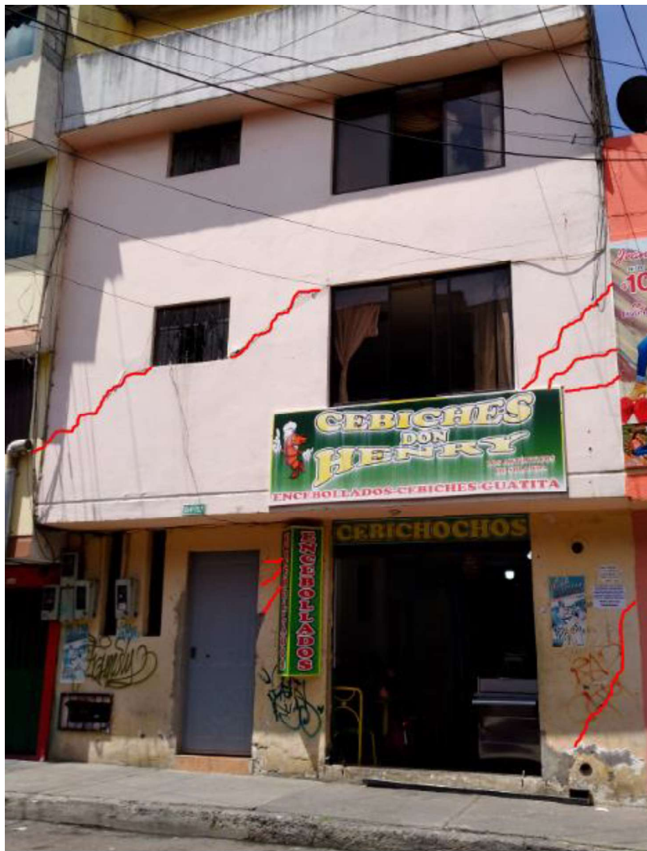
Figura 20- Grietas en vivienda de 3 pisos con terraza
