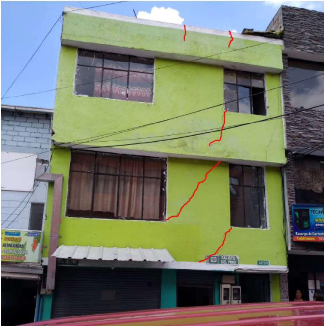
Figura 21- Grietas en vivienda de 3 pisos con terraza
