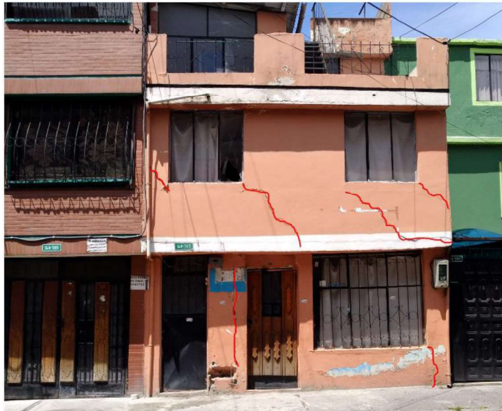
Figura 18 -Grietas en vivienda de 3 pisos
