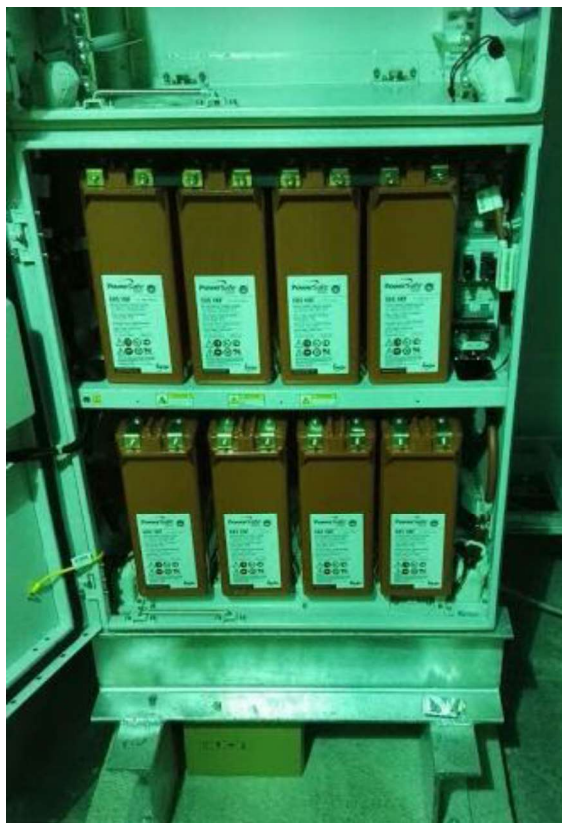
Figura 2.36. Banco de baterías.
