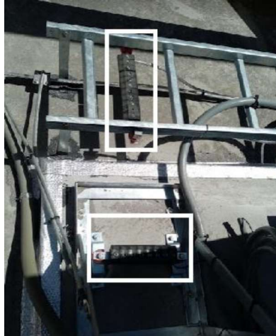
Figura 2.38. Puesta a tierra en escalerilla horizontal.
