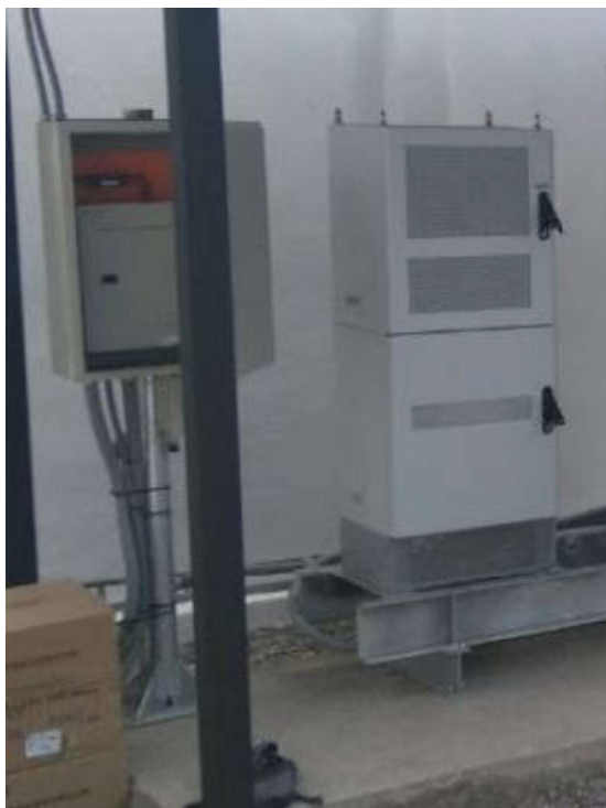
Figura 3.2. Equipos shelters instalados.
