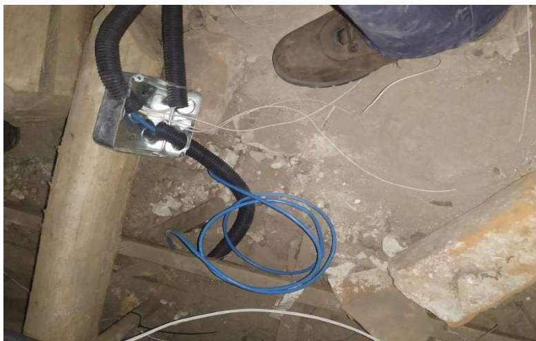
Figura 3.26: Primer cajetín de paso
