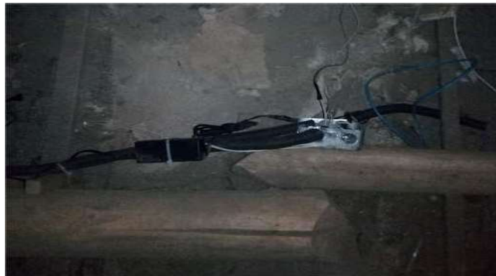
Figura 3.36: Fuente DC de alimentación del biométrico
