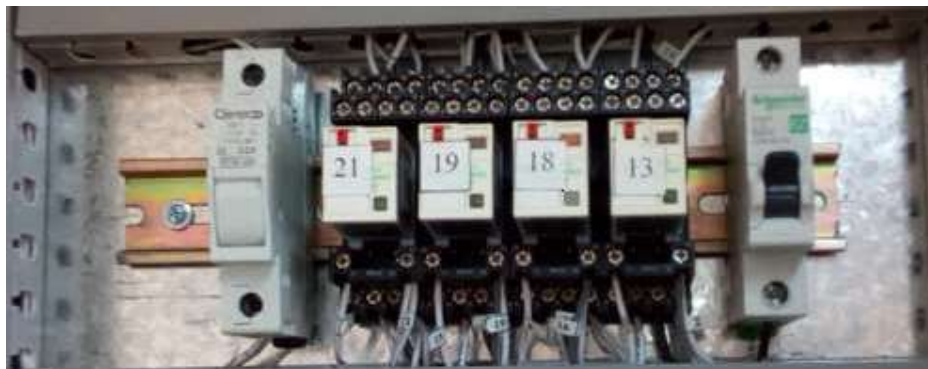
Figura 3.16: Conexión de los terminales del relé para el sensado de luminarias
