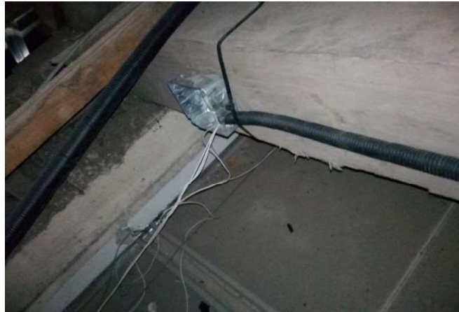
Figura 3.27: Segundo cajetín de paso
