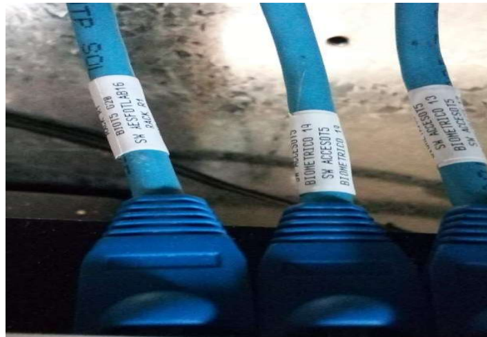
Figura 3.29: Etiquetado del cable UTP
