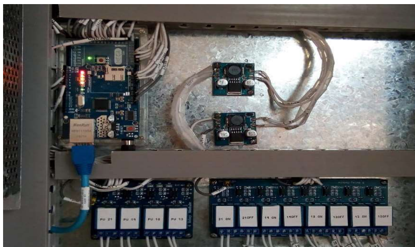
Figura 3.46: Shield Ethernet con enlace UTP
