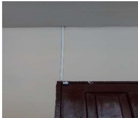
Figura 3.38: Instalación y conexión del sensor puerta
