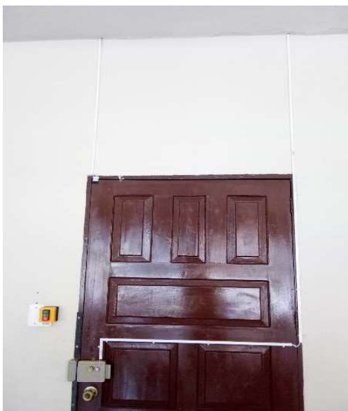
Figura 3.33: Cableado de la cerradura eléctrica
