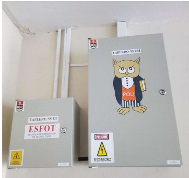
Figura 3.25: Gabinetes instalados en el aula 18
