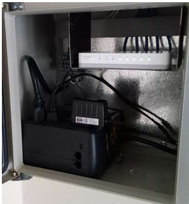
Figura 3.45: Estado de los LEDs del switch D-Link
