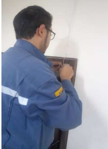
Figura 3.13 Cableado de sensores magnéticos en puertas
