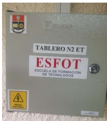
Figura 3.11 Tablero número 2 de telecomunicaciones
