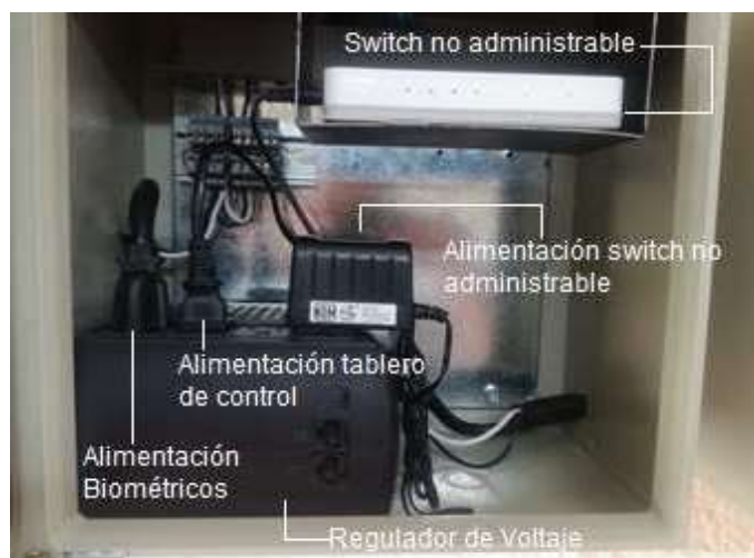
Figura 3.12 Elementos del tablero de telecomunicaciones
