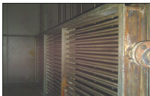
Figura 1.18 Radiadores de hierro fundido (Calentadores)
