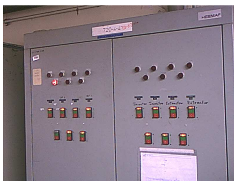
Figura 3.7 Armario de control del encendido del sistema de aire acondicionado, antes de las modificaciones.
