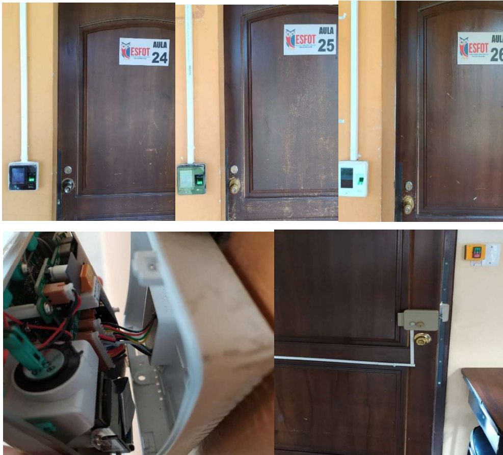
Figura 3.19 Instalación del hardware del sistema de control de acceso
