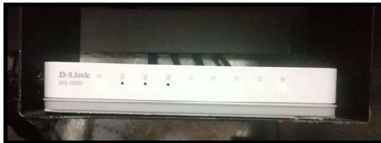
Figura 8. Switch de comunicación
