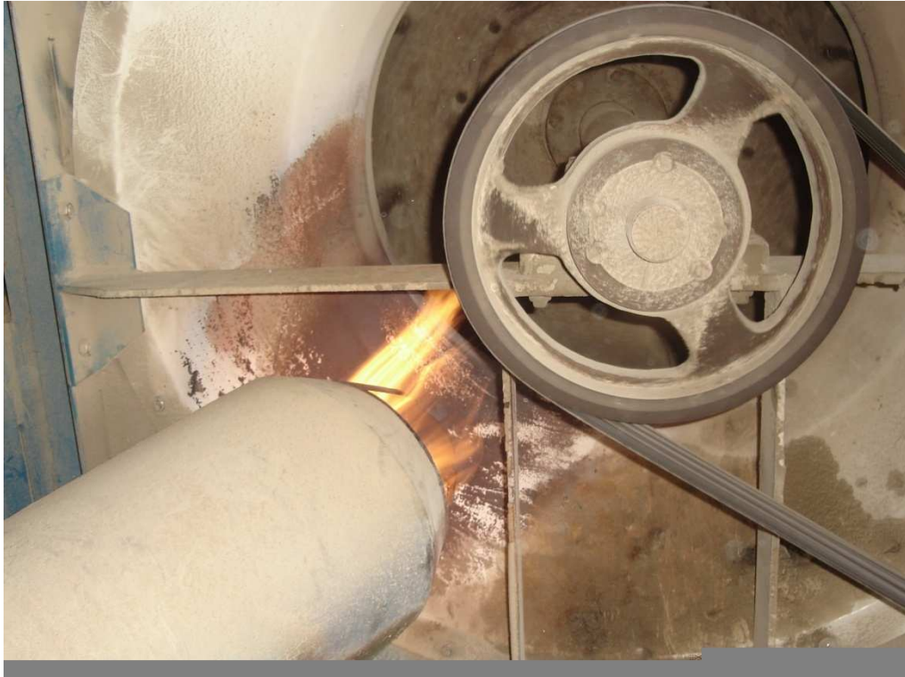
Figura 3.11 Oxidación en el ventilador y quemador
