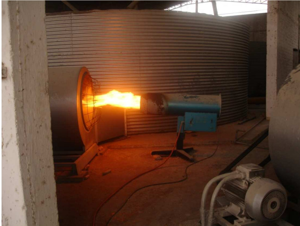
Figura 3.10 Quemador sin cámara de combustión.
