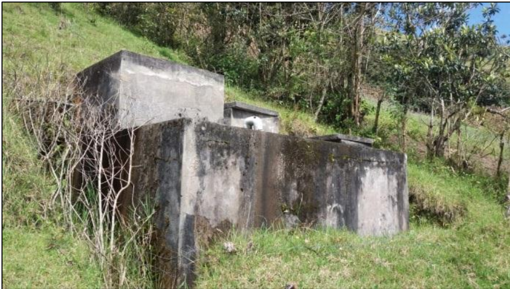
Figura 8. Tanque de Desinfección
