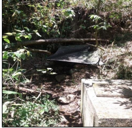
Figura 34. Captación de Agua de la Vertiente
