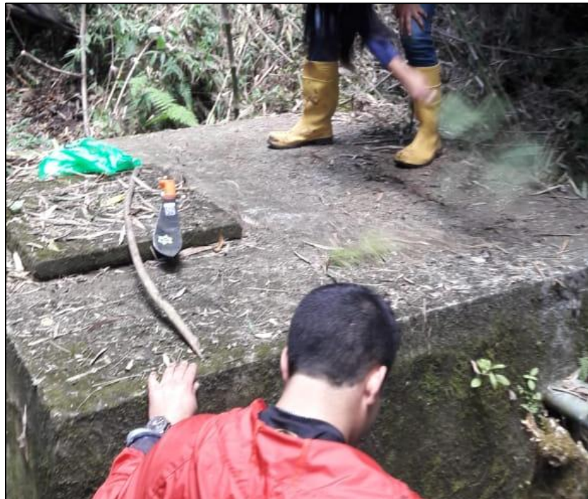
Figura 6. Tanque de captación
