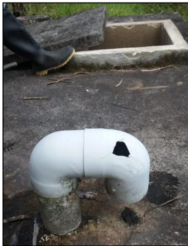
Figura 38. Chimenea de Extracción de Gases
