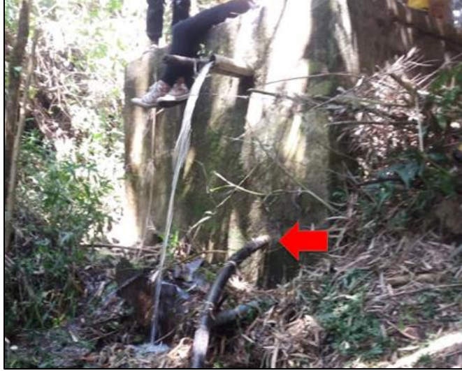
Figura 7. Salida de tubería del Tanque de Captación
