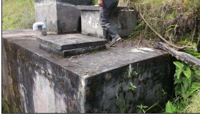
Figura 37. Tanque de Desinfección
