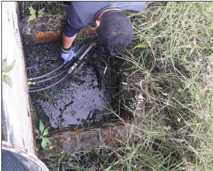
Figura 9. Salida de Tubería del Tanque de Desinfección
