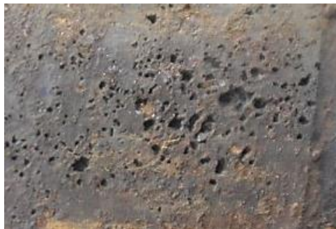
Figura 1.27. Corrosión por picaduras.
