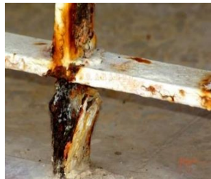
Figura 1.29. Corrosión por esfuerzo. (Fuente: ingenieriamecanicacol.blogspot.com )
