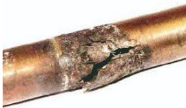
Figura 1.15. Corrosión en grietas (Hassani et al., 2011, p.11)
