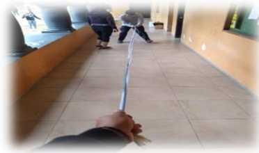
Figura 3.13 Tendido del cable UTP cat. 5e y de los cables eléctricos 20AWG.
