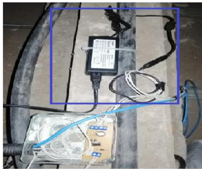
Figura 3.31 Fuente de alimentación del terminal biométrico.
