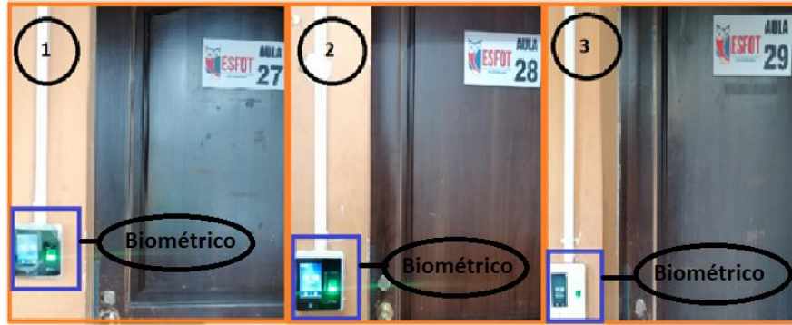
Figura 3.32 Terminales biométricos instalados.
