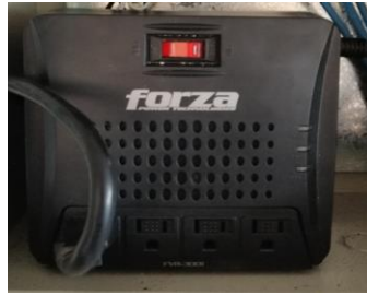
Figura 1.7 Regulador de voltaje Marca FORZA FVR-3001.
