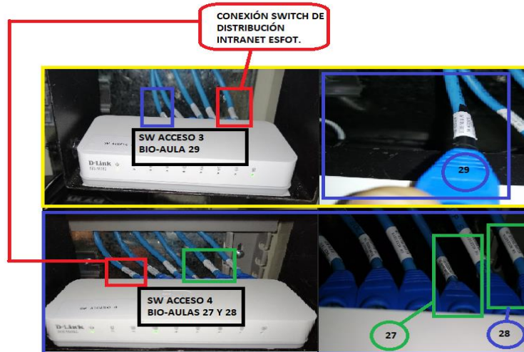
Figura 3.27 Cables de conexión conectados a los switches de acceso N° 3 y N° 4.
