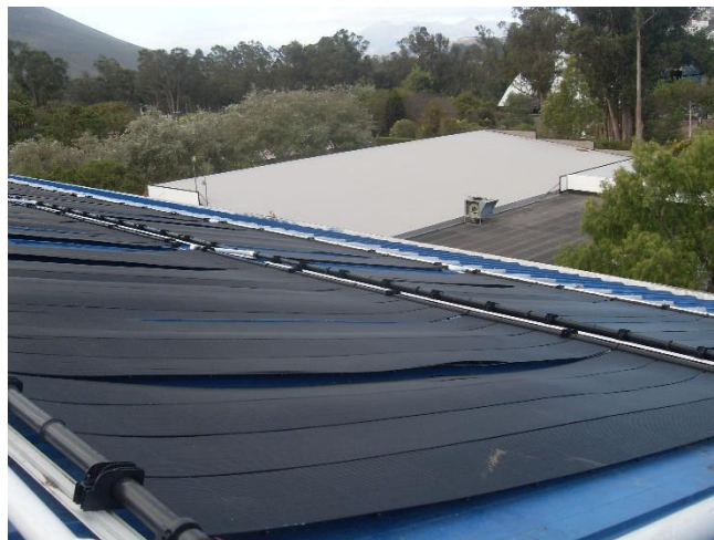
Figura 26. Colectores de tubos de vacío. (Fuente: Propia)
