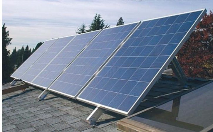
Figura 25. Colectores planos no protegidos. (Fuente: https://www.caloryfrio.com/energias-renovables/energia-solar/colectores-solares-planos-proteccion-contrasobrecalentamiento-thermprotect-de-viessmann.html .)
