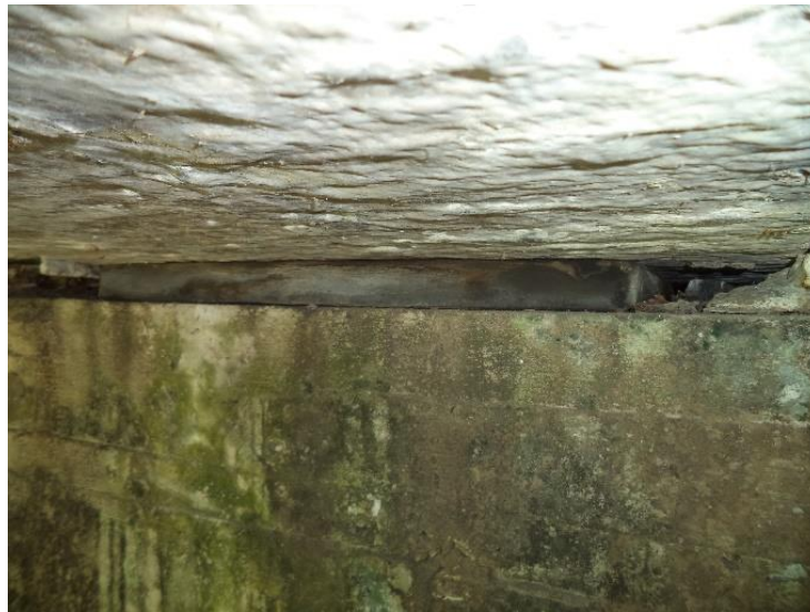
FIGURA 3.15 Apoyo de Neopreno en el puente
