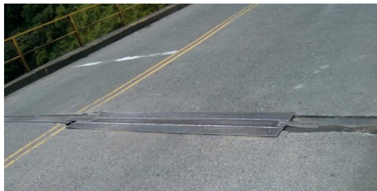
FIGURA 2.11 Junta del Puente de la Hidroeléctrica Agoyán (Tungurahua)
