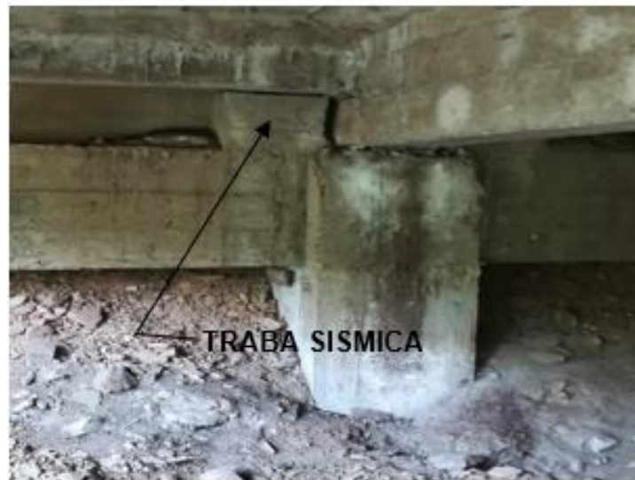
FIGURA 3.10 Trabas sísmicas del puente
