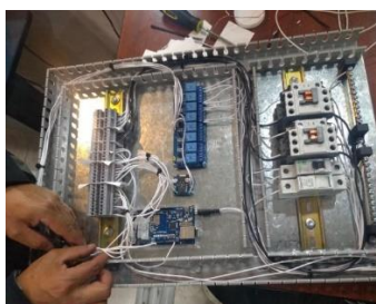
Figura 3.32. Cableado del circuito de control y monitoreo.
