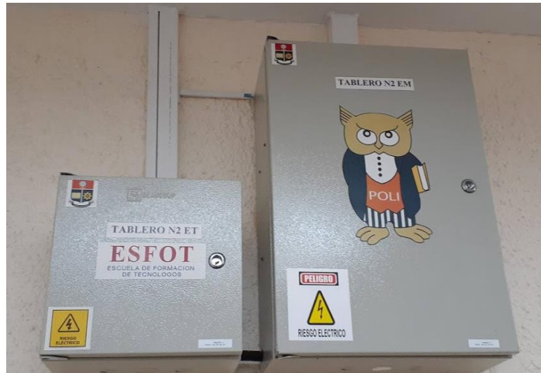
Figura 3.38. Tablero 2 Finalizado. Fuente: Propia.
