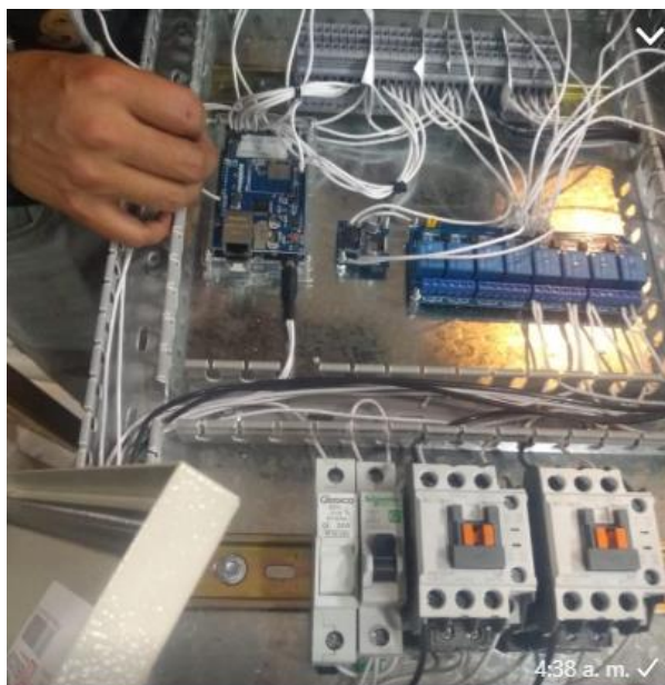
Figura 3.31. Cableado del circuito de luminarias. Fuente: Propia.
