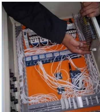
Figura 3.34. Montaje de los interruptores circulares y de la fuente de Voltaje. Fuente: Propia.
