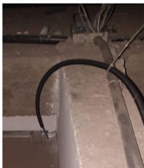
Figura 3.24. Canaletización AC y DC. Fuente: Propia.
