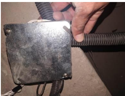
Figura 3.22. Acometida. Fuente: Propia.
