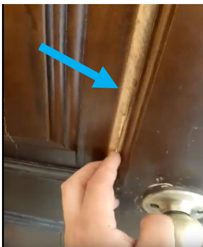
Figura 3.5. Fisura por forcejeo de puerta. Fuente: Propia.
