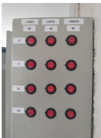
Figura 3.40. Interruptores circulares para control manual de emergencia. Fuente: Propia.
