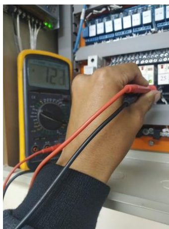
Figura 3.39. Pruebas de caídas de tensión Fuente: propia
