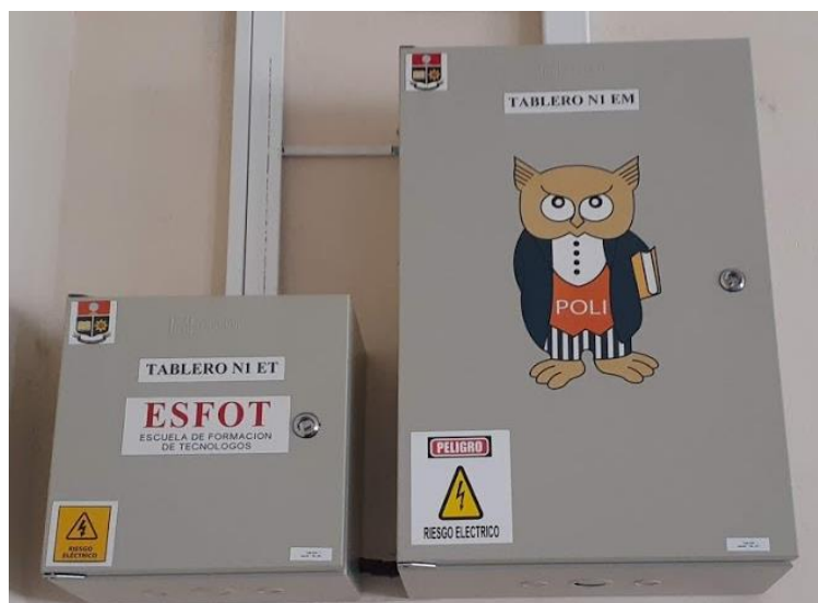
Figura 3.37. Tablero 1 finalizado. Fuente: Propia.
