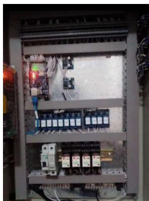
Figura 3.36. Alimentación de tableros. Fuente: Propia.
