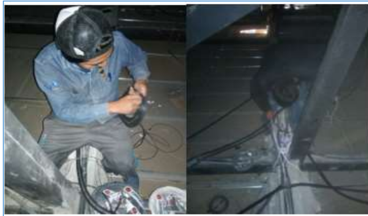
Figura 3.31: Paso de cable a través de tubería para alimentación principal de tablero. Fuente: Propia
