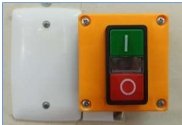
Figura 3.35: Modelo de interruptor instalado en cada aula Fuente: Propia
