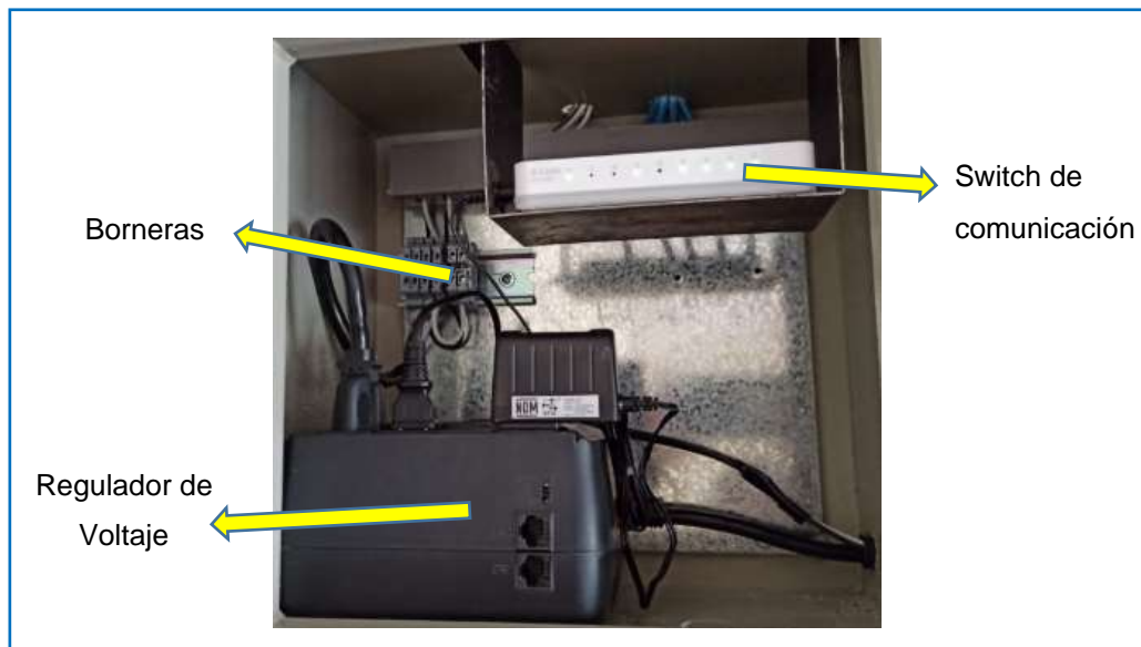
Figura 3.5: Componentes del tablero secundario ET. Fuente: Propia
