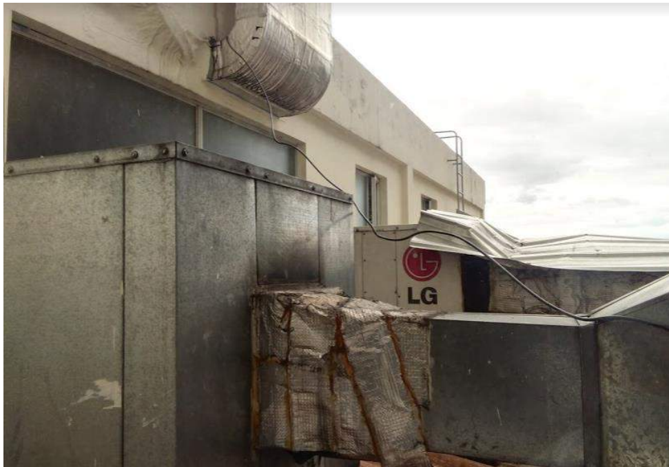
Imagen p. Ductos con aislamiento en pésimas condiciones. Fuente: Propia, Hospital Enrique Garcés.
