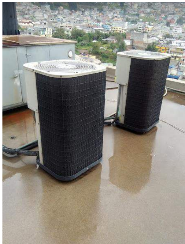
Imagen f. Sistema doméstico multi-split exterior conectado a UMA (A).
