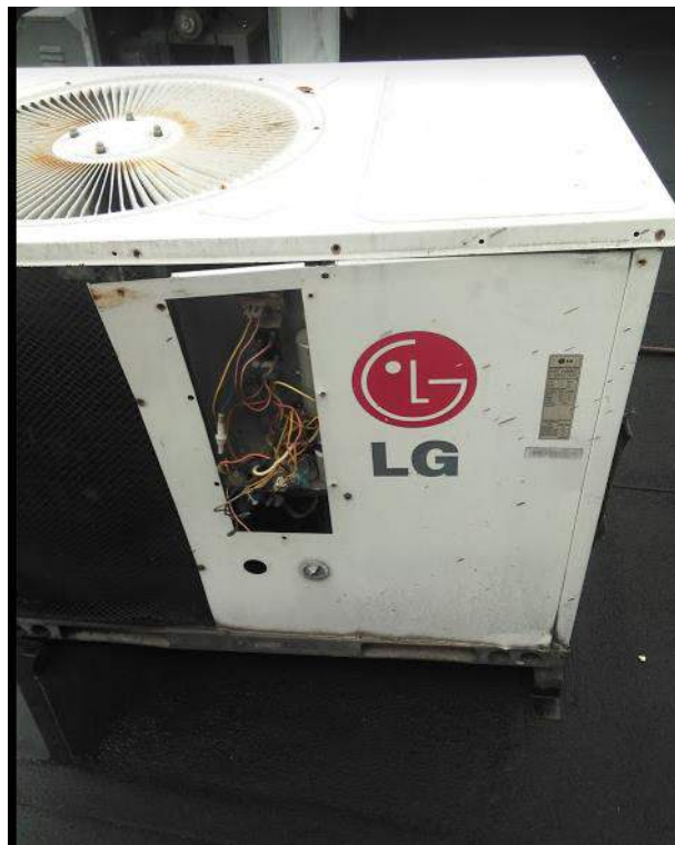
Imagen l. Acondicionador marca LG totalmente en desuso.
