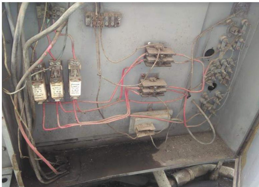
Imagen h. Sistema eléctrico de la UMA (B), donde se observa su obsolescencia y antigüedad. Fuente: Propia, Hospital Enrique Garcés
