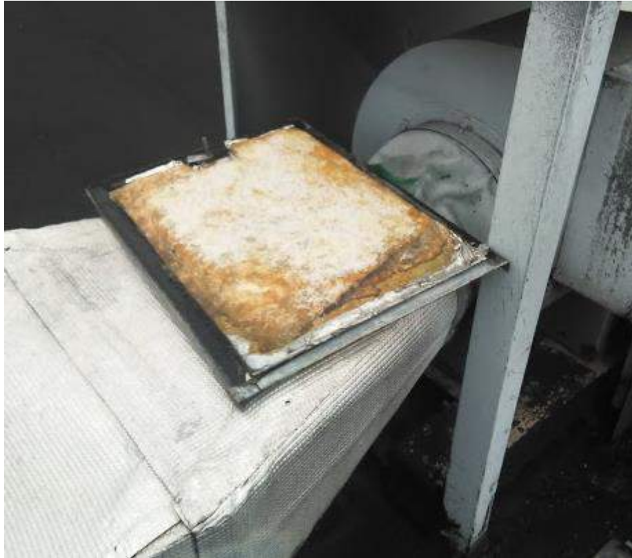
Imagen o. Filtro de UMA de habitaciones del 3er piso. Fuente: Propia, Hospital Enrique Garcés.
