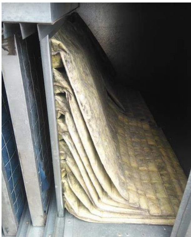
Imagen n. Filtros de la UMA de diversos cuartos del 4to piso. Fuente: Propia, Hospital Enrique Garcés.
