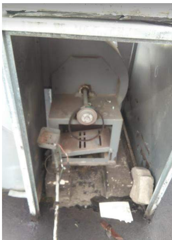
Imagen j. Ventilador de extracción de los quirófanos del 4to Piso. Donde claramente está obsoleto por la falta de un motor.
