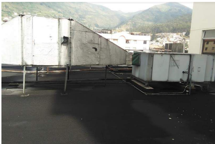
Imagen i. Unidad manejadora (C) de los quirófanos del cuarto piso. Donde se evidencia el deterioro del aislamiento, así como de su antigüedad.
