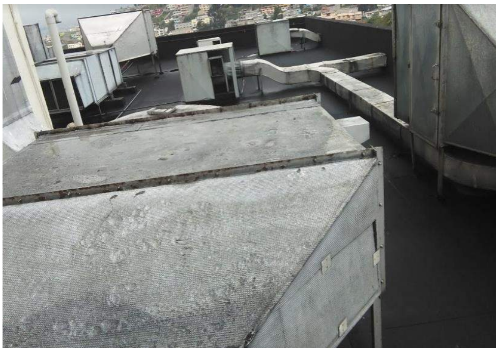
Imagen m. Imagen de la terraza del 4to piso del HEG, donde se aprecia las UMAs y ventiladores de las diferentes habitaciones. Fuente: Propia, Hospital Enrique Garcés.
