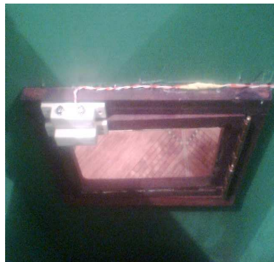
Figura 2.44 Sensores Magnéticos instalados
