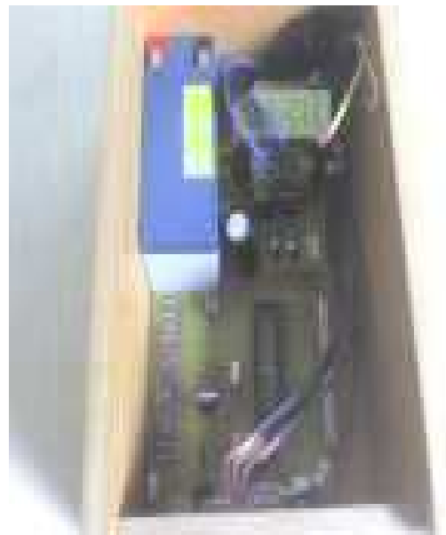
Figura 2.34 Parte interna de la central
