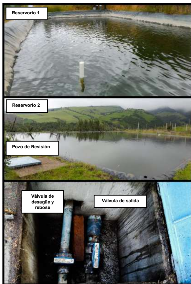
Figura 24 Caja de válvulas de reservorios
