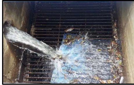
Figura 22 Tanque de llegada
