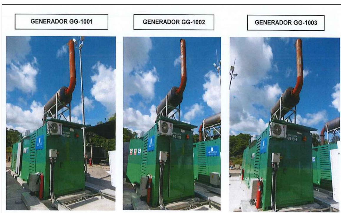
Figura 2.11: Generadores de Electricidad Waukesha Fuente: QA/QC Petroamazonas
