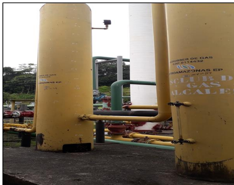
Figura 2.3: Depuradores de gas Estación Cuyabeno
