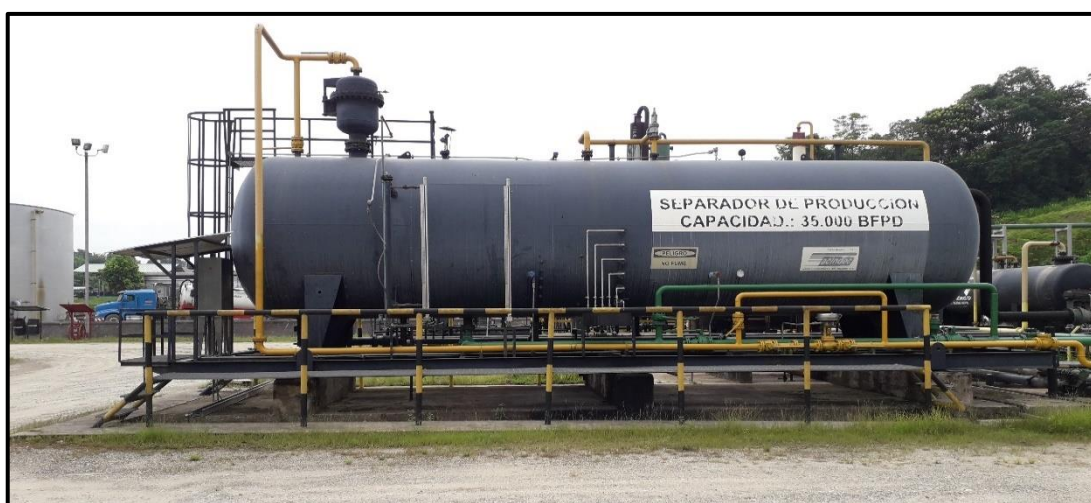
Figura 1.3: Separador de Producción Fuente: Mantenimiento PAM
