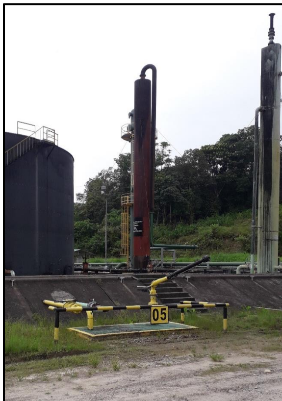
Figura 1.4: Bota de Gas Fuente: Mantenimiento PAM
