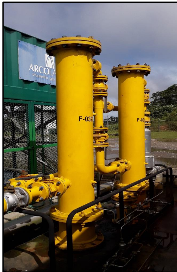
Figura 2.10: Filtro coalescente F-0321 Fuente: Mantenimiento PAM
