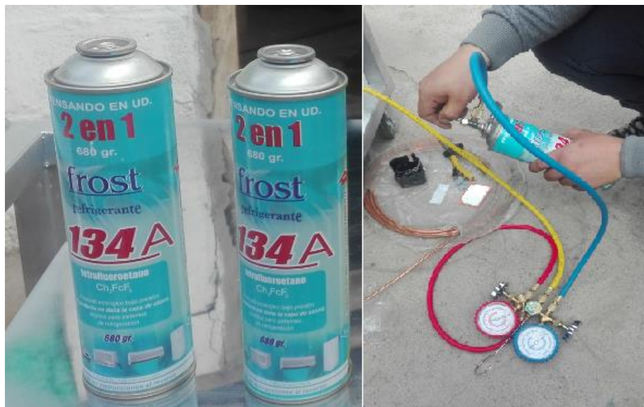
Figura 3.33. Carga de refrigerante R134a.
