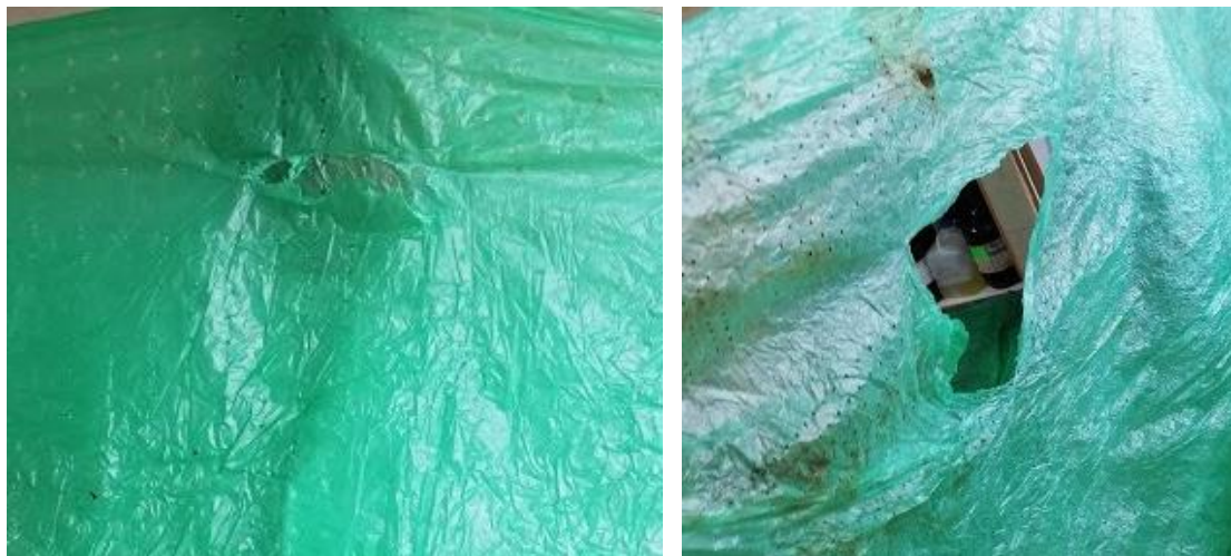
Figura 11. Daños físicos en las bolsas plásticas. Elaborado por: Cando e Inga, 2019
