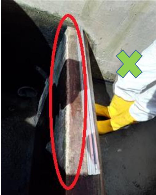
Figura 20. Desgaste del vertedero
