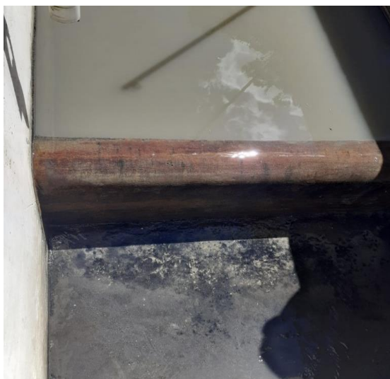
Figura 6. Vertedero tipo Creager de la PTAR Lloa
