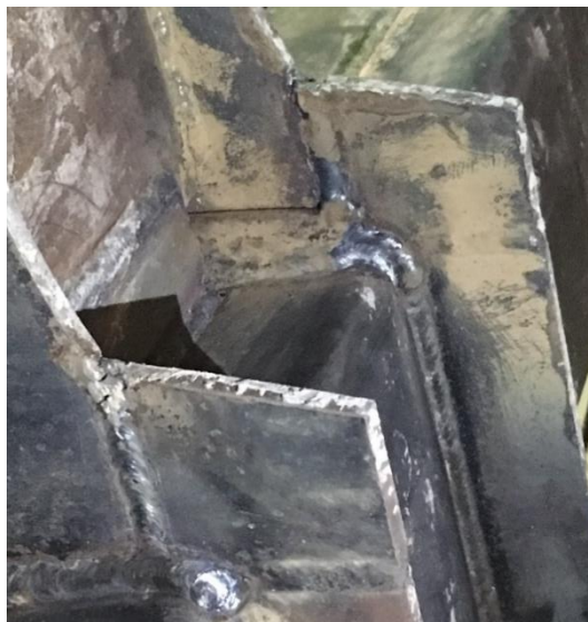
FIGURA 4.35 Falla de la soldadura entre la placa de refuerzo trapezoidal y el ala de viga
