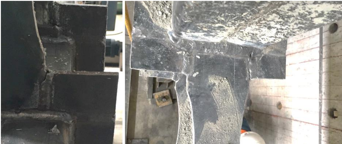
FIGURA 4.28 Falla de la soldadura entre las vigas y las placas de refuerzo
