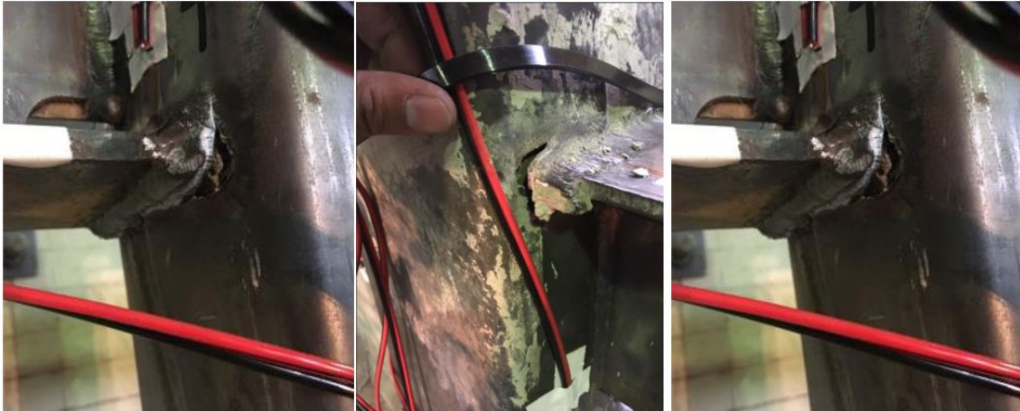
FIGURA 4.21 Desprendimiento de acero de las columnas
