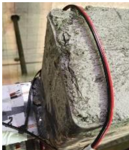
FIGURA 4.22 Pérdida de adherencia entre hormigón y acero de las columnas
