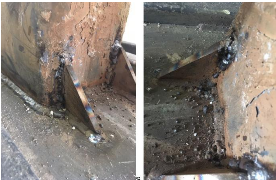
FIGURA 4.29 Falla de la soldadura entre las columnas y sus placas de refuerzo en la base
