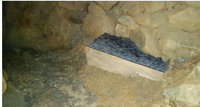
Figura 3. 2. Caja de captación
