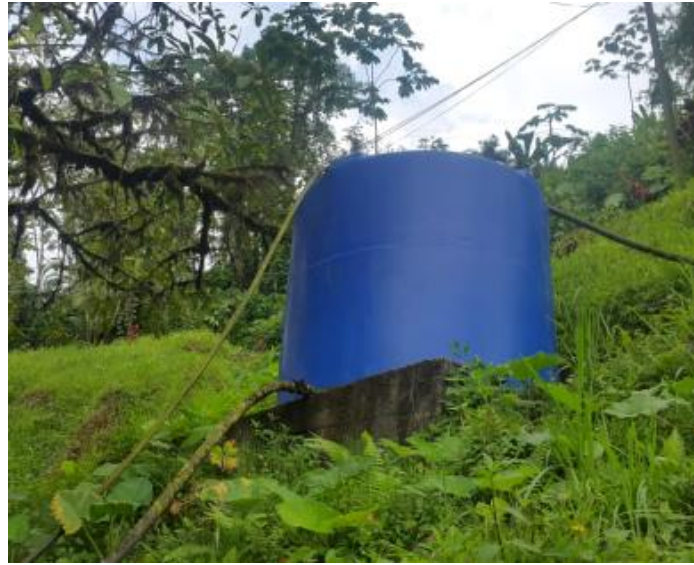
Figura 3. 4. Reservorio de regulación
