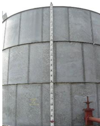
Figura 2. 9. Taque de agua del SCI de estación LAC Fuente: (Acosta, 2008)
