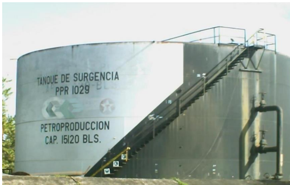
Figura 2. 5. Tanque de reposo de estación LAC Fuente: (Ramirez, 2009)
