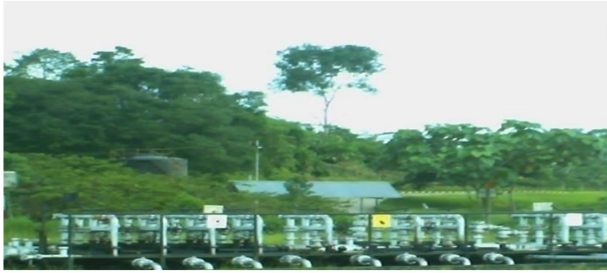
Figura 2. 2. Manifolds de estación LAC
