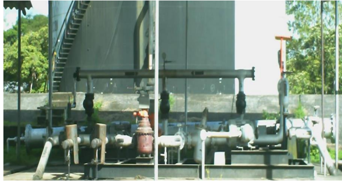
Figura 2. 6. Bombas booster para oleoducto de estación LAC Fuente: (Ramirez, 2009)
