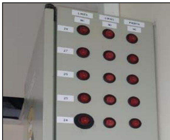
Figura 3.39: Identificación de interruptores.
