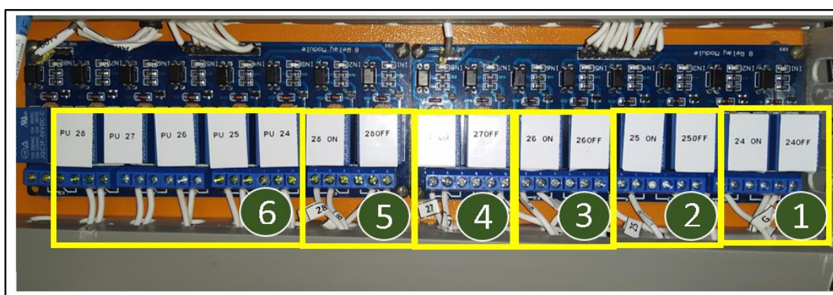
Figura 3.30: Grupos de relés de control ON/OFF de luces y apertura de puertas. (Fuente Propia)
