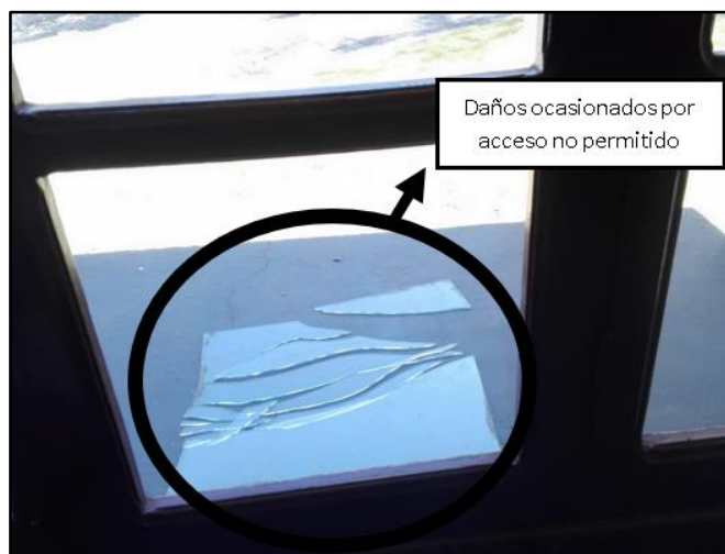
Figura 3.3: Daños a ventanas de las aulas. (Fuente Propia)
