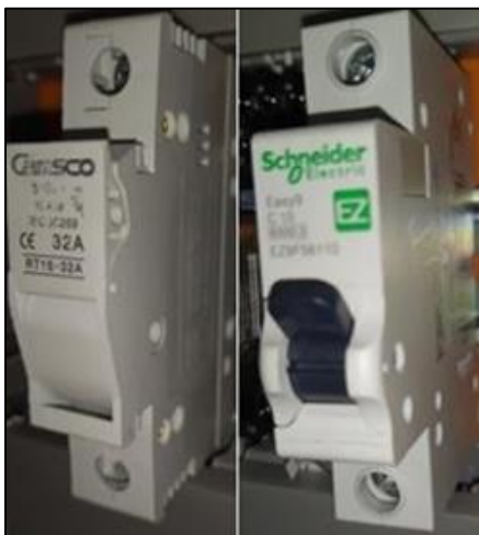
Figura 3.34: Grupo de protecciones eléctricas del tablero.
