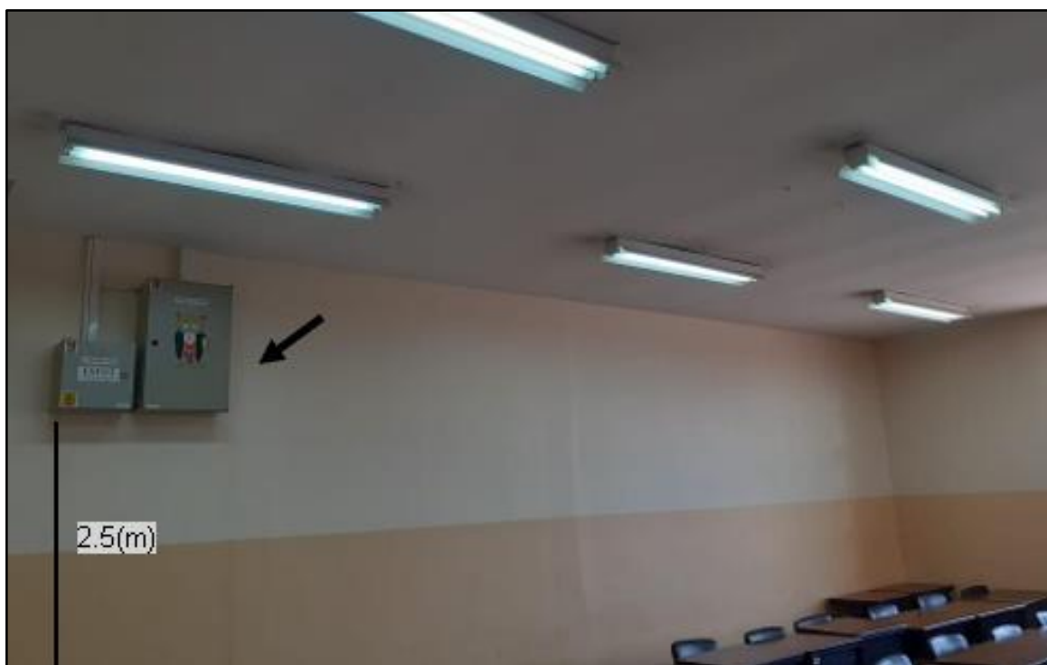
Figura 3.37: Ubicación Tablero de Control Aula 26.
