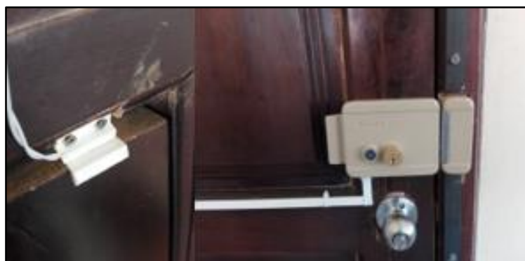
Figura 3.40: Cableado de sensores y chapas eléctricas.
