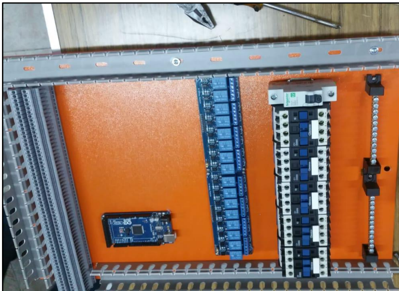
Figura 3.23: Instalación de los elementos en la placa del tablero de control. (Fuente Propia)
