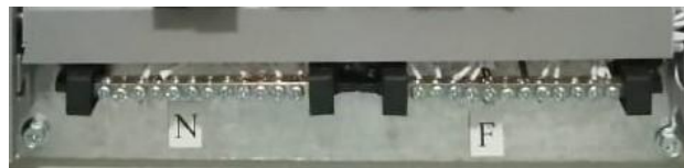
Figura 3.18 Regletas de distribución del tablero. (Fuente Propia)
