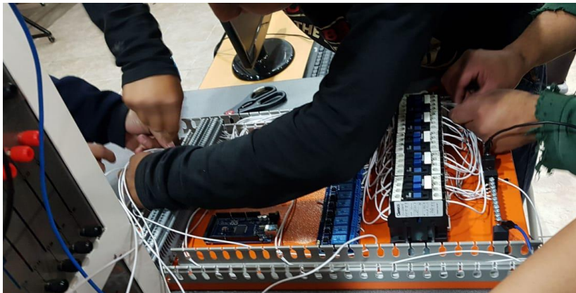
Figura 3.27 Pruebas de continuidad del tablero de control (Fuente Propia)
