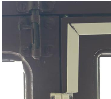
Figura 3.24 Direccionamiento del cable hacia el techo-tablero de control sensores ventanas (Fuente Propia)
