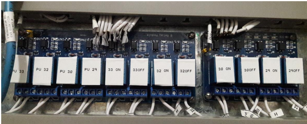
Figura 3.15 Módulos relé del tablero (Fuente Propia)
