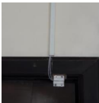
Figura 3.22 sensores colocados en las puertas (Fuente Propia)
