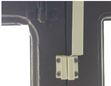
Figura 3.21 Sensores colocados en las ventanas (Fuente Propia)
