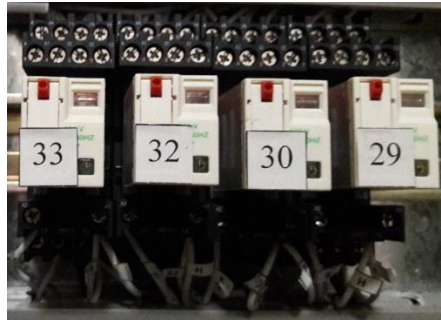
Figura 3.17 Relés industriales del tablero (Fuente Propia)
