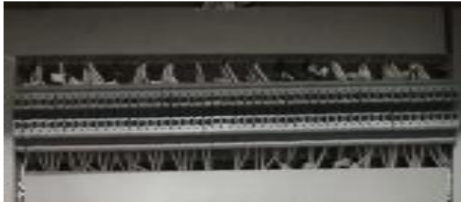
Figura 3.9 Borneras industriales del tablero 3 (Fuente Propia)
