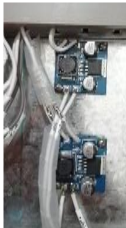
Figura 3.14 Módulos convertidores de voltaje (Fuente Propia)
