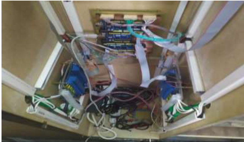
Figura 3.13: Conexión entre módulos relé y Arduinos
