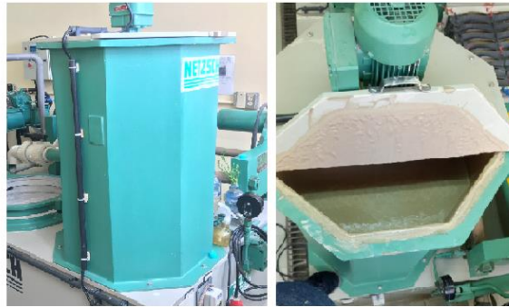
Figura 2. Tanque de alimentación
