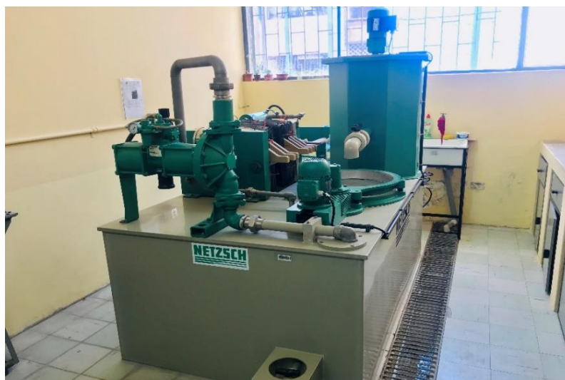
Figura 3.2. Estado inicial Monoblock Filtroprensa. (Fuente: Propia)
