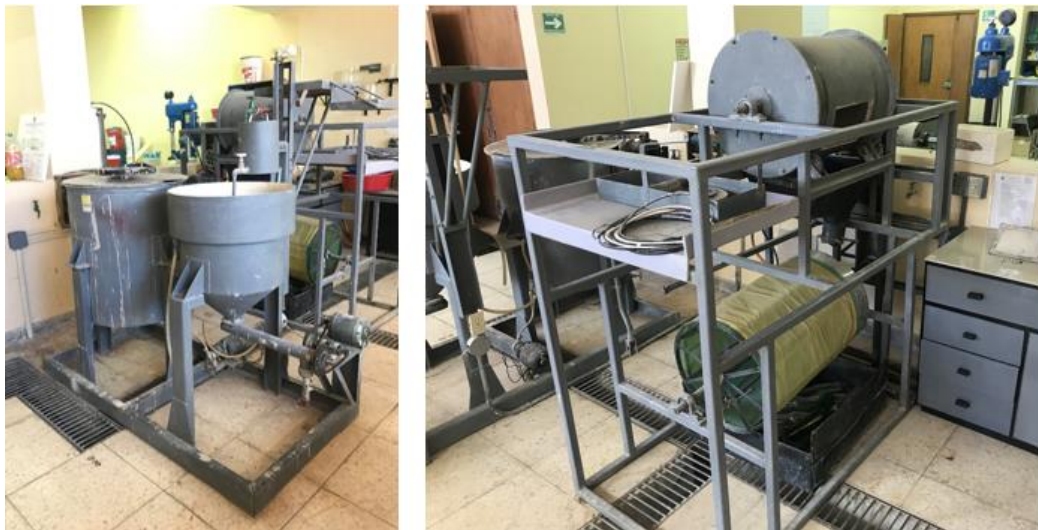
Figura 3.1. Estado inicial purificadores. (Fuente: Propia)
