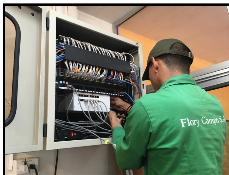
Figura 3.23: Conexiones en el rack de la zona B.
