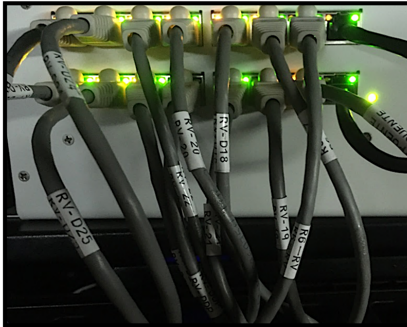
Figura 3.13: Etiquetado de enlace del cableado.
