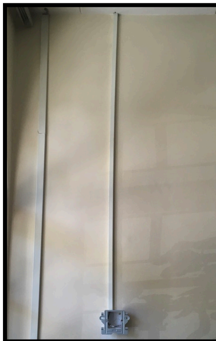
Figura 3.8: Anclaje de cajas terminales en oficinas de la zona D.
