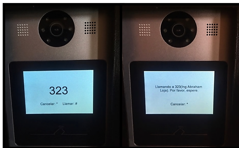
Figura 3.45: Comunicación placa externa-monitores por marcado directo.
