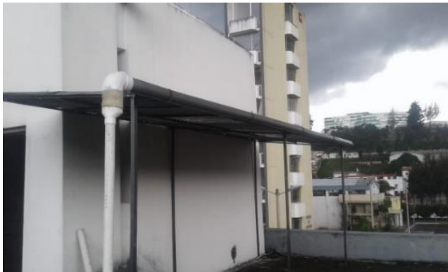
Figura 3.16 Canaleta y bajante
