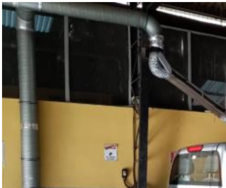
Figura 2.7. Ductos de extracción de gases de escape. (Fuente: Los Autores, 2020)
