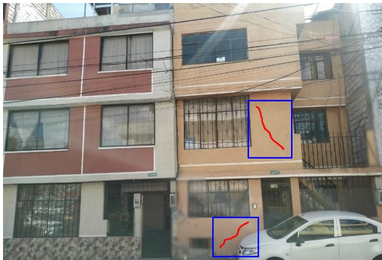
Fotografía 10 Nivel de amenaza igual a 2 (media) aparición de fisuras diagonales
