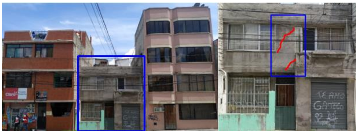
Fotografía 11 Nivel de amenaza igual a 2 (media) causado por el aumento de pisos
