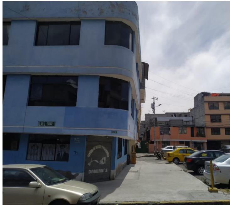
Fotografía 7 Afectación por subsidencias de suelo ELABORADO POR: AGUAIZA
