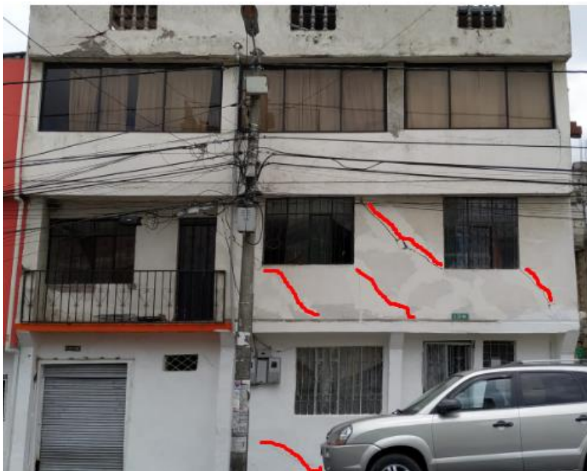
Fotografía 12 Nivel de amenaza igual a 3 (alta) representado por la aparición de grietas y la degradación de la rigidez y resistencia
