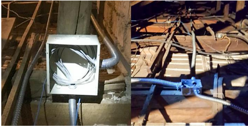
Figura 3.12: Caja de derivación
