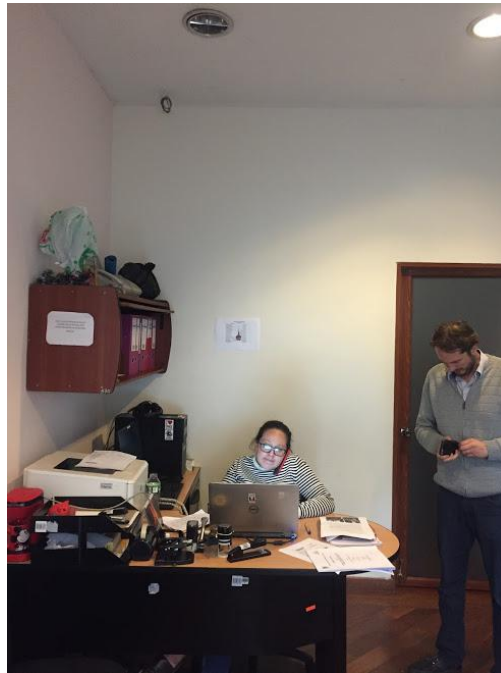
Figura 3.1. Estado del sistema de iluminación en el área de secretaría
