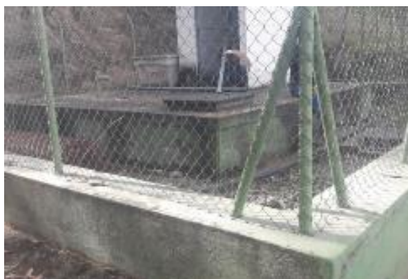
Fotografía 6 Tanque de distribución para el barrio Nitiluisa Centro
