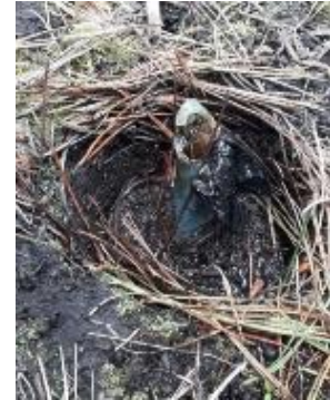
Fotografía 12 Válvula de aire dañada
