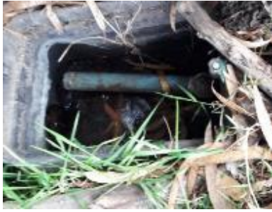
Fotografía 13 Válvula para purga dañada
