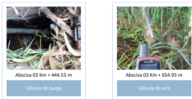
Figura 3.8 Puntos de fuga de caudal
