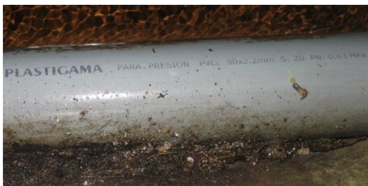
Fotografía 17 Especificaciones de la tubería utilizada en el primer tramo de la conducción
