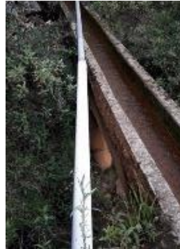
Fotografía 11 Tubería de acero en paso elevado
