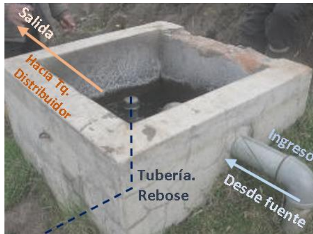
Fotografía 3 Tanque Rompe Presiones
