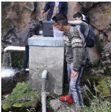
Figura 16 Tanque de captación en la Fuente Pailacocha
