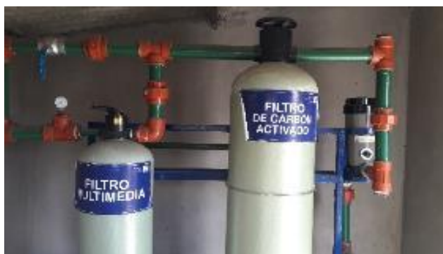
Fotografía 8 Planta de tratamiento de agua de consumo del barrio Luisa Rumipamba
