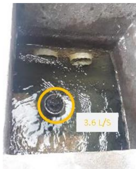
Fotografía 2 Tanque de captación en la Fuente Pailacocha Disposición de tuberías
