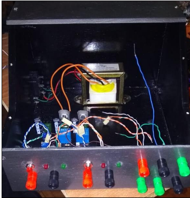
Figura 3.60: Proceso de conexión de fuentes y borneras.
