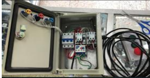
Figura 2.63: Caja de control con inversor de giro. (Fuente: Propia)
