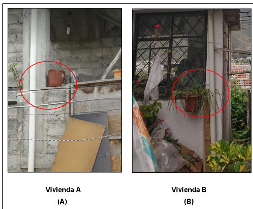
Figura 41. Columna corta en viviendas.
