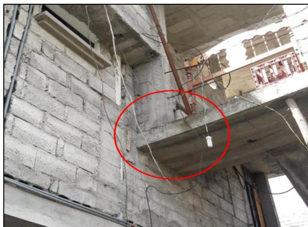
Figura 43. Viga sobrecargada en viviendas. Elaborado por: Castillo, C. & Castillo, J.
