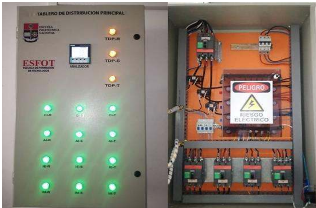
Figura 3.1 Tablero de distribución principal.
