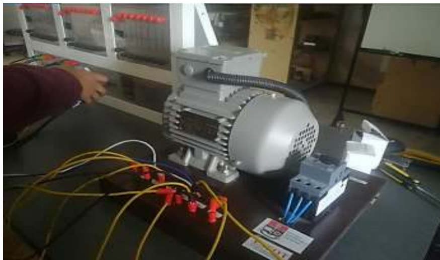
Figura 3.4 Mesa de trabajo del laboratorio de Control Industrial.
