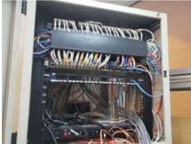
Figura 3.11 Cableado hasta el rack 6 área de oficinas 2
