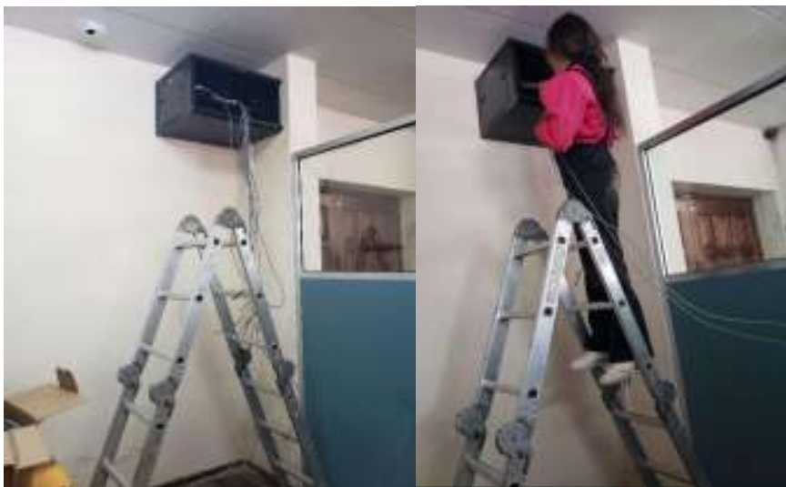
Figura 3.10 Cableado hasta el rack área de oficinas 3
