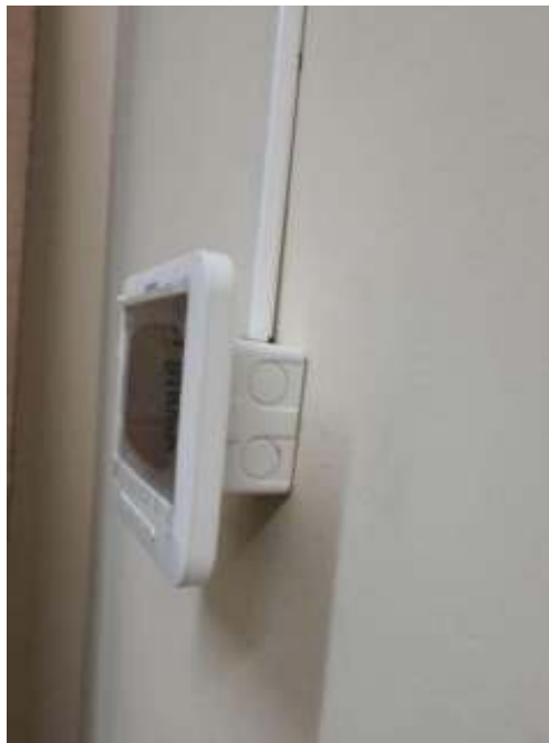
Figura 3.39 Colocación de estación interior
