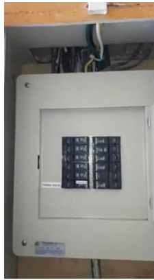
Figura 3.10 Punto 1: Tablero de distribución
