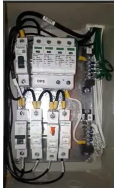
Figura 3.4 Tablero de protecciones
