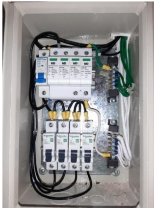
Figura 3.13 Tablero de protección de la zona 3.
