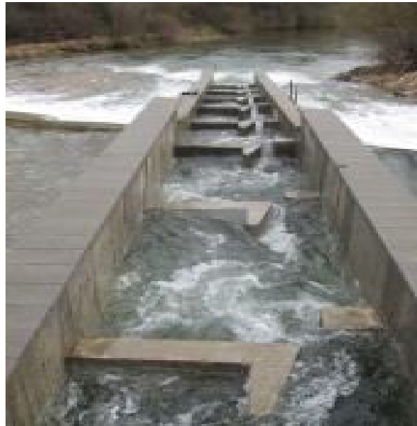
Figura 10 Escalera de peces tipo ranura vertical en el río Porma
